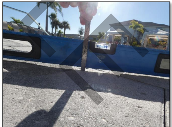
65 - Uneven / sunken / displaced pavers. M08_(2233)
